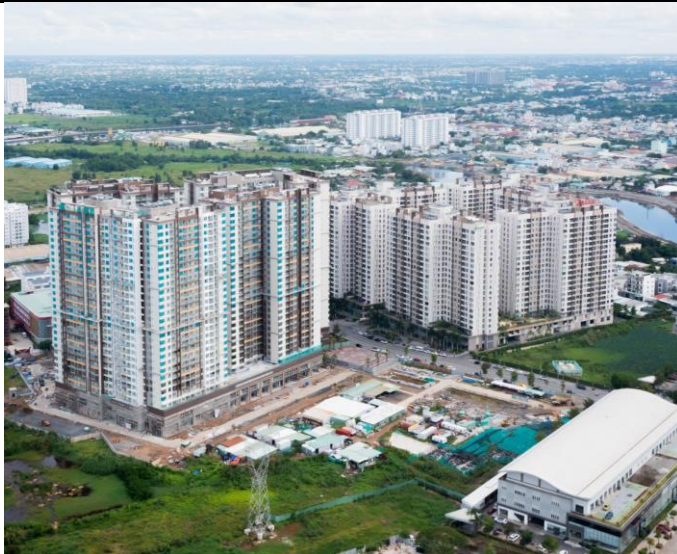
Hình 17: Dự án Akari City: Đã hoàn thành cốt nóc giai đoạn 2 và dự kiến bắt đầu bàn giao vào Q4/24
